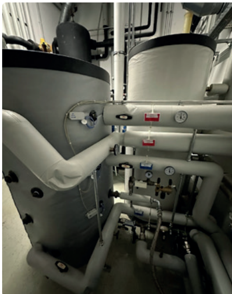
Wärmerückgewinnung aus Technikum und Produktion
